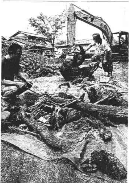
公園の土を掘って出てきた木の幹や根、コンクリートブロック。二十四日、岐阜県本巣市の文殊団地で
